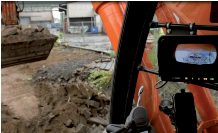
Am Knickarm montierte Funkkamera zur direkten Kontrolle der Arbeiten im Einsatzbereich eines Grabenräumlöffels.
